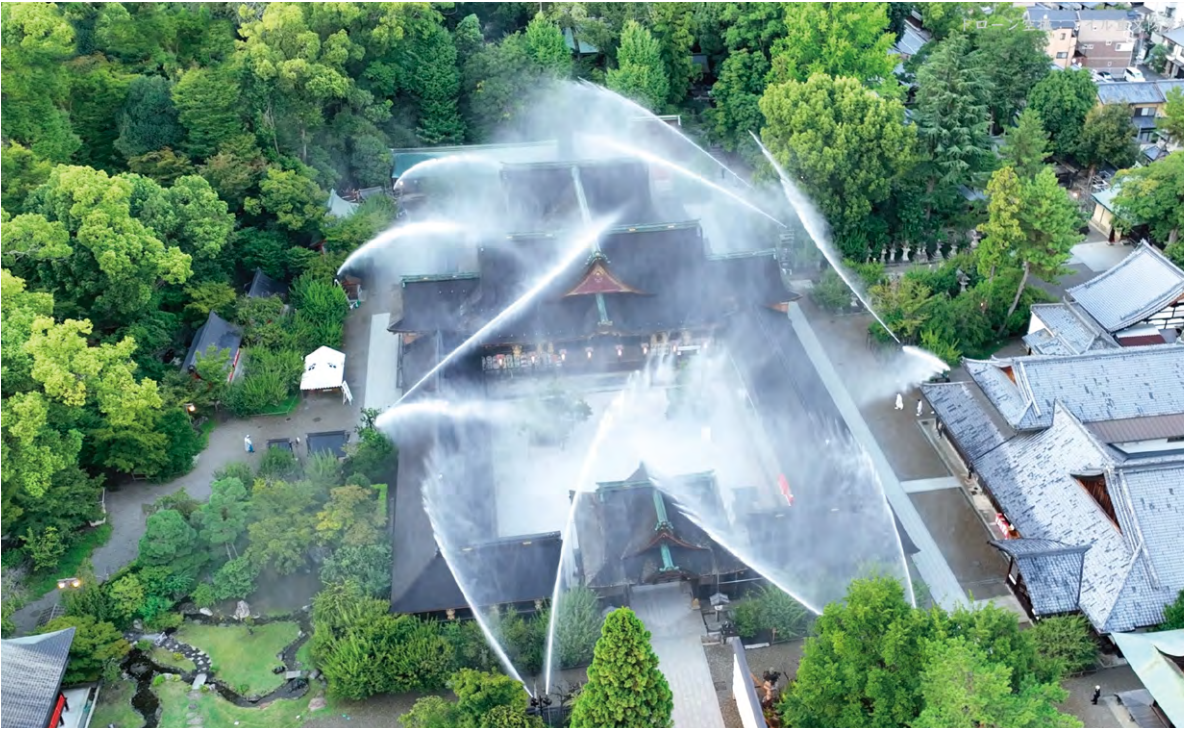
国宝の御本殿を守るため、改修された防災設備
