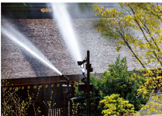
新たに設置された放水設備
