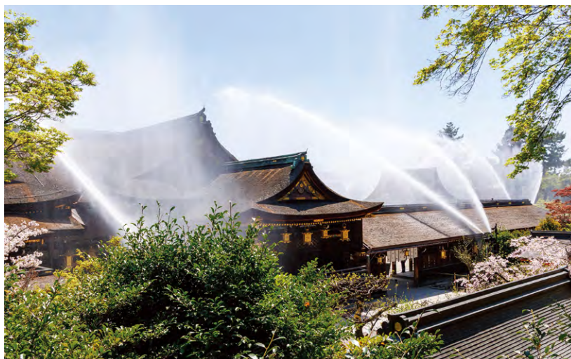
国宝の御本殿を守るため、改修された防災設備
